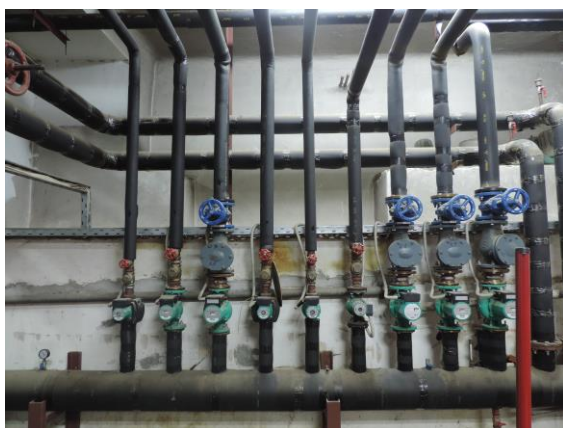
Σωλήνες μεταφοράς νερού στο λεβητοστάσιο
