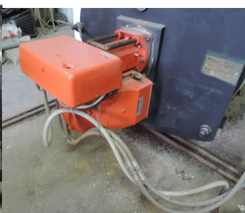
2ος καυστήρας και λέβητας
