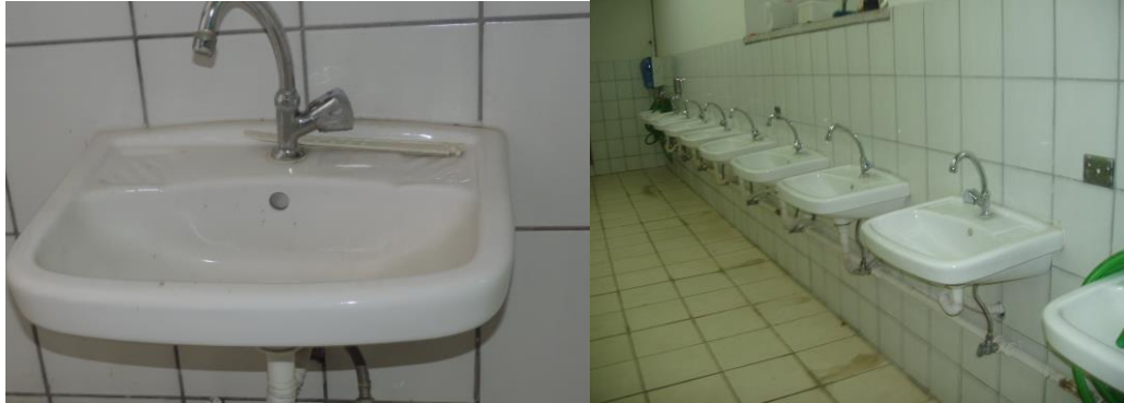
Νιπτήρες και βρύσες νερού του σχολείου
