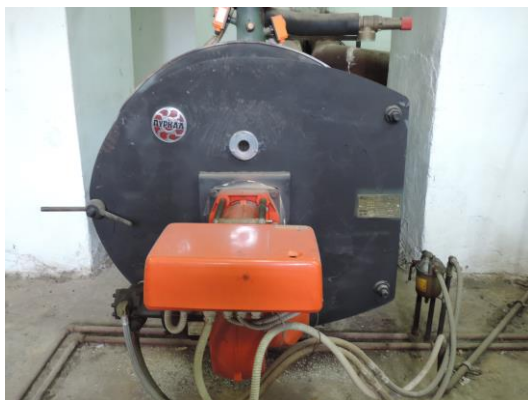
1ος καυστήρας και λέβητας
