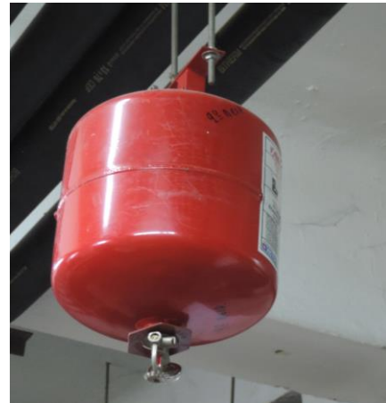
Πυροσβεστήρας οροφής του λεβητοστασίου
